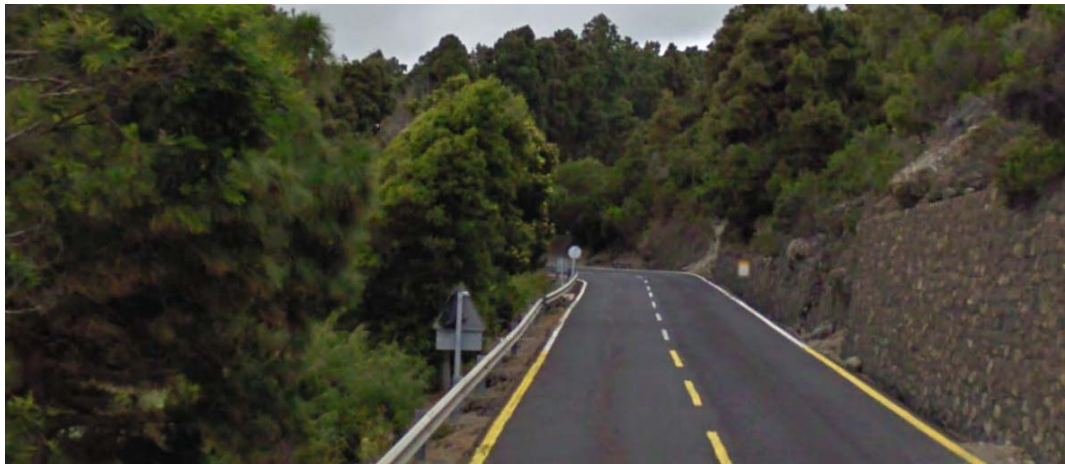
Foto nº 5: Falta de arcén en la Carretera de la Guancha (TF-342).
